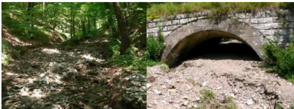
Le ponceau ferroviaire devant le tunnel Bujanovský recouvert de gravier provenant de l'activité d'érosion dans les forêts (2010)
